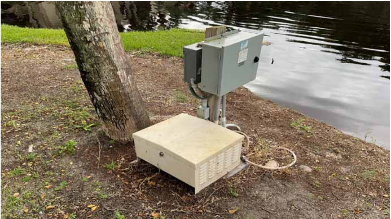
Lake Aerator Compressor
