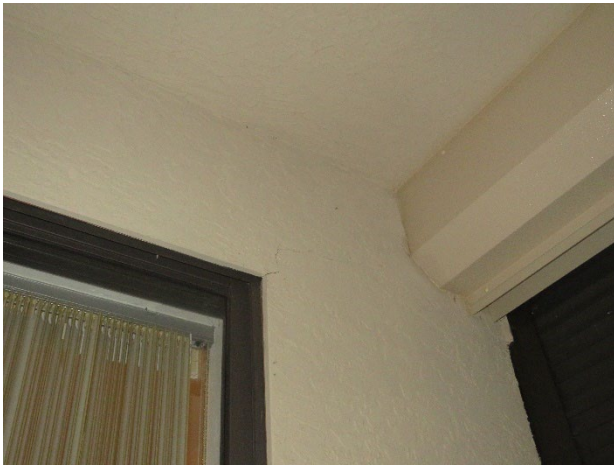
Balcony wall crack, Unit E105
