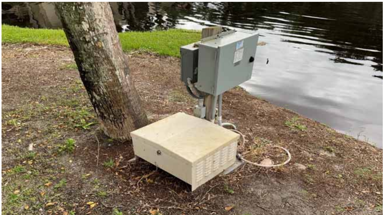
Lake Aerator Compressor
